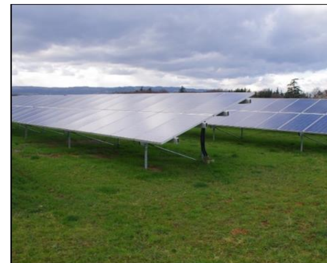
Reprise végétale sous les panneaux photovoltaïques
